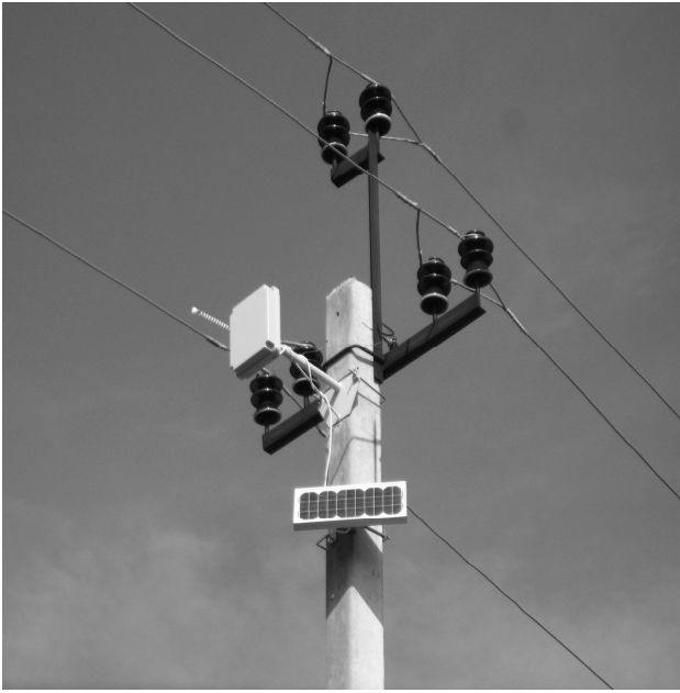
Рисунок 1 - Фіксатор на опорі ПЛ 10 кВ
