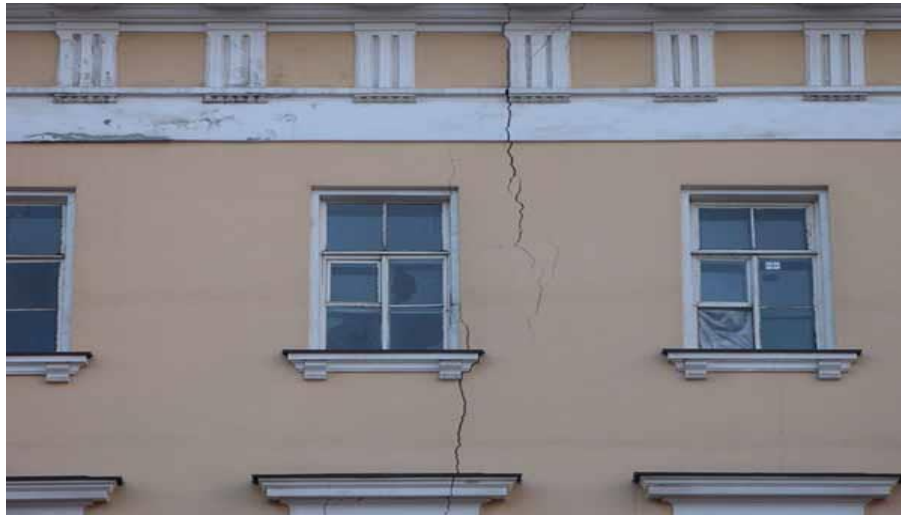
Рис. 1.7 – Слабке руйнування будівлі
