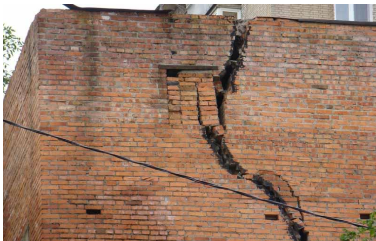
Рис. 1.6– Середнє руйнування будівлі
