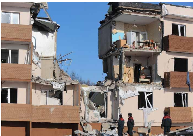
Рис. 1.5 – Сильне руйнування будівлі
