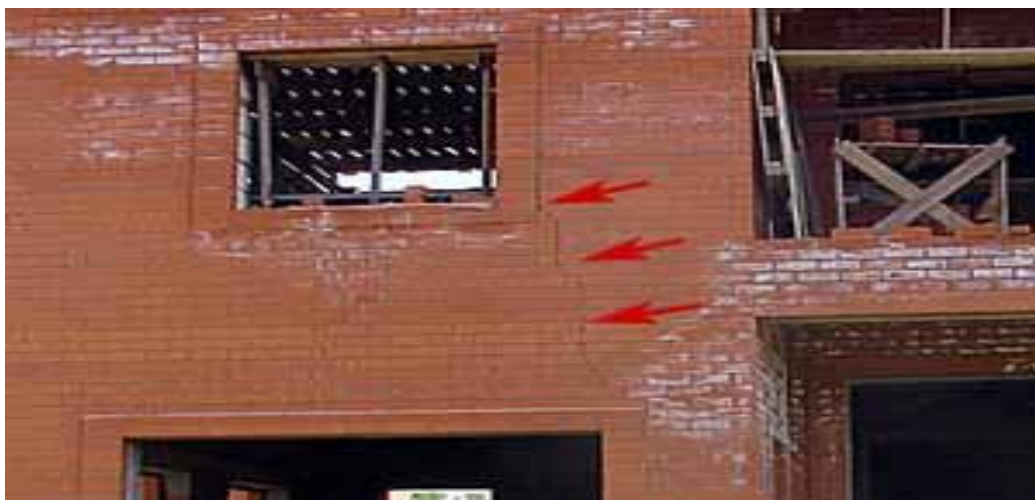
Рис. 1.8 – Легке пошкодження будівлі.
