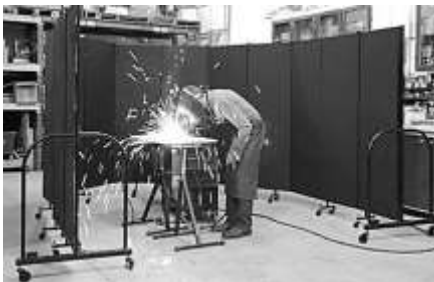
Захисний екран Protective screens on the welding area
