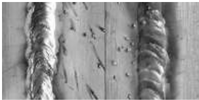
Зварний шов Welding seam
