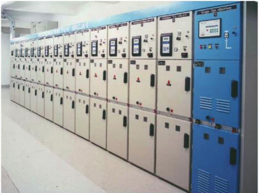
Рис. 4. Загальний вигляд закритого КРП 10 кВ на основі комірків серії D-12Р виробництва компанії «Таврида Електрик»
