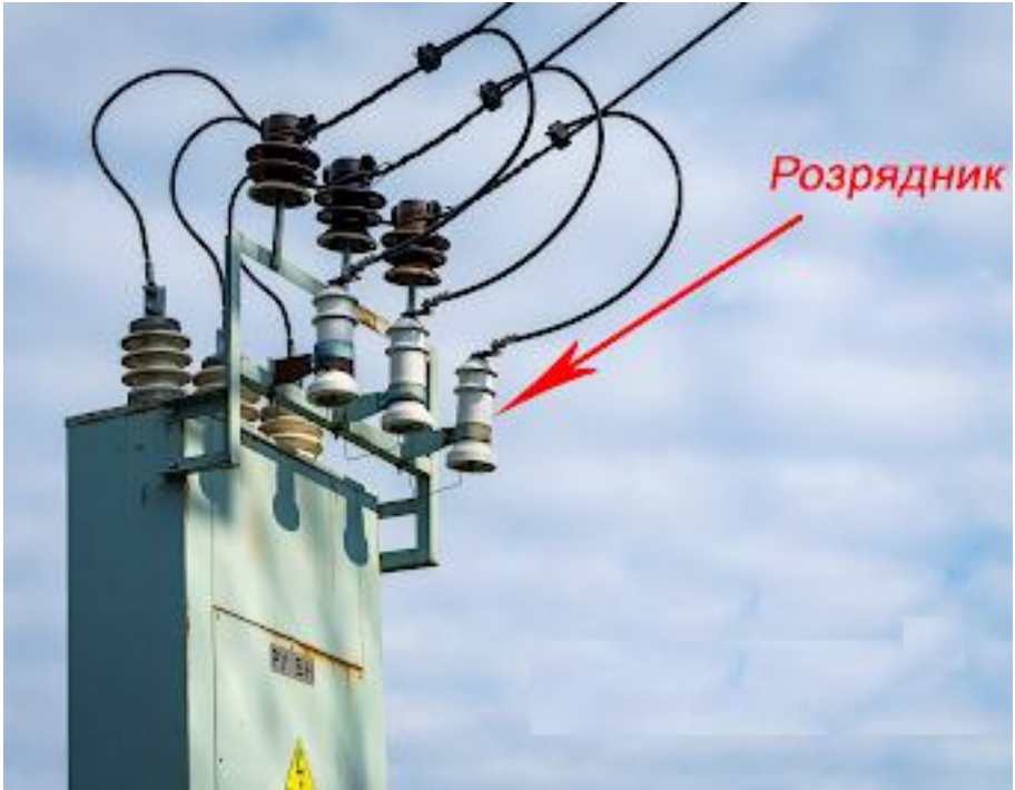
Рисунок 1 - Зовнішній вигляд вентильних розрядників на КТП 10/0,4 кВ.
