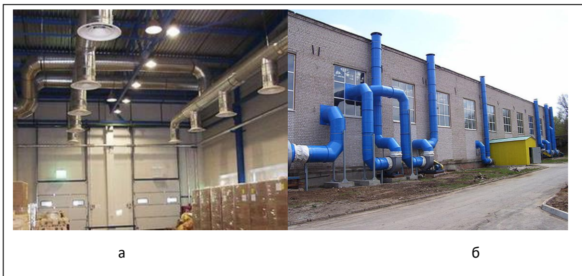
Рис. 16 - Повітроводи штучної вентиляції: а) всередині виробничого приміщення; б) зовні
