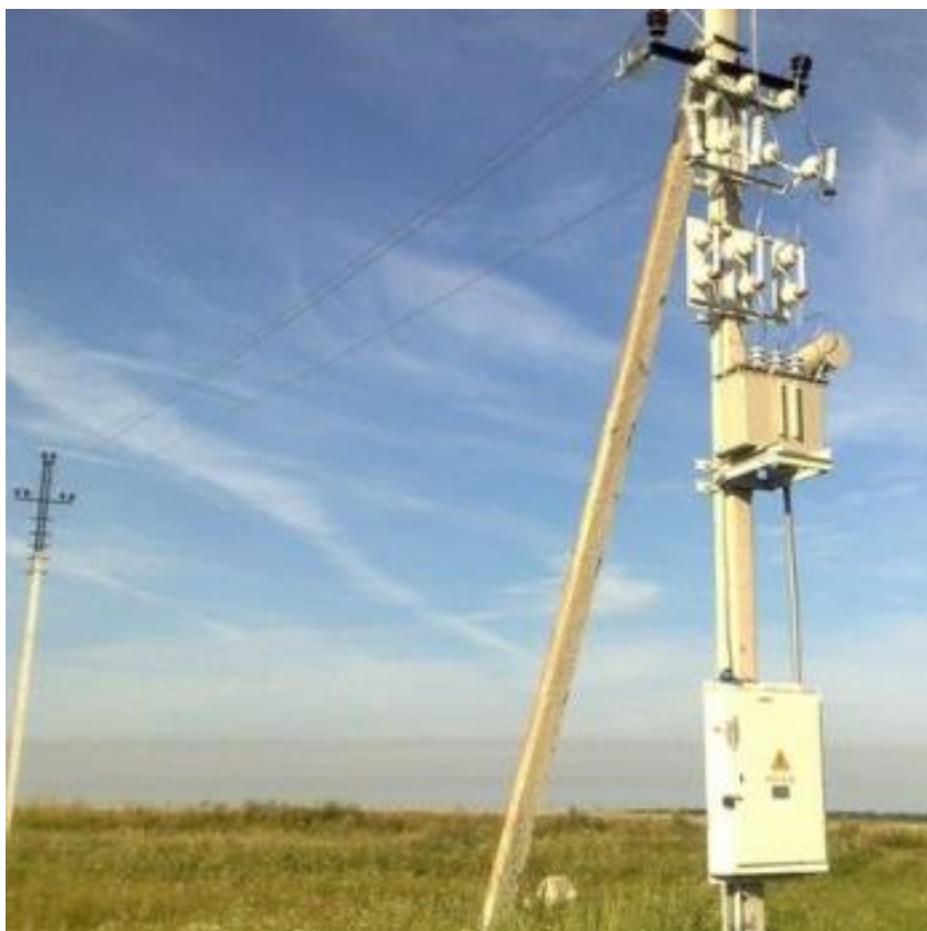
Рисунок 5 – Щоглова трансформаторна підстанція КТП-Ш (шафного типу).
