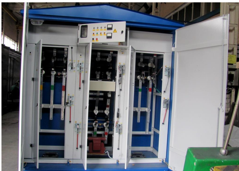
Рисунок 4 - Прогідна трансформаторна підстанція 10/0,4 кВ.
