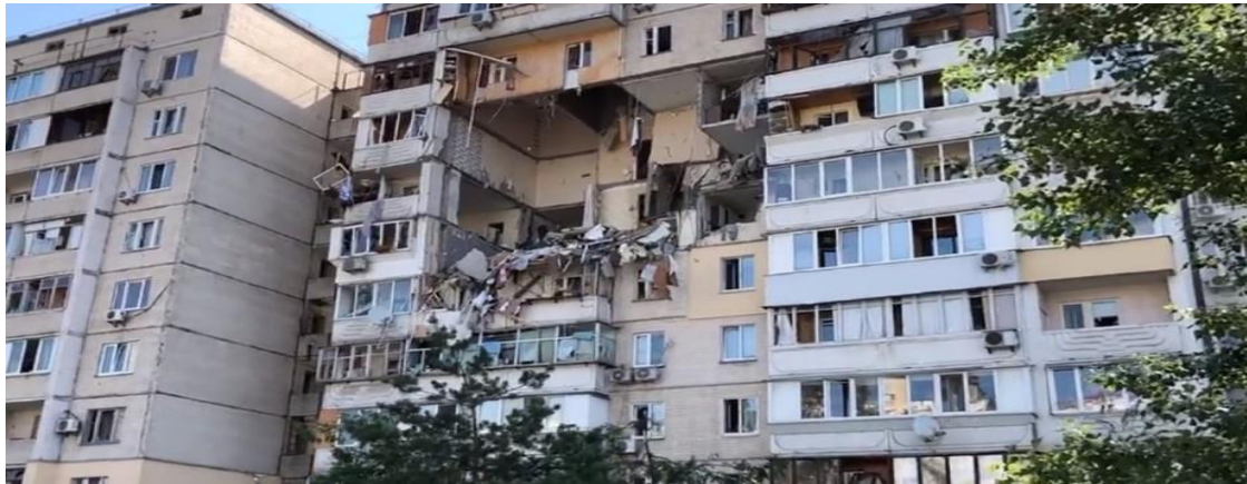
Рис. 2.8 Напівзруйнований будинок на Позняках
