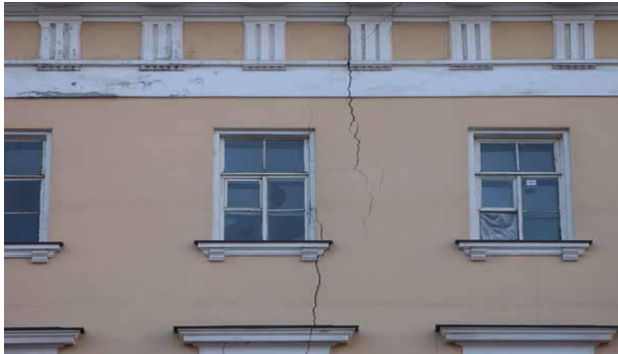
Рис. 1.7 – Слабке руйнування будівлі
