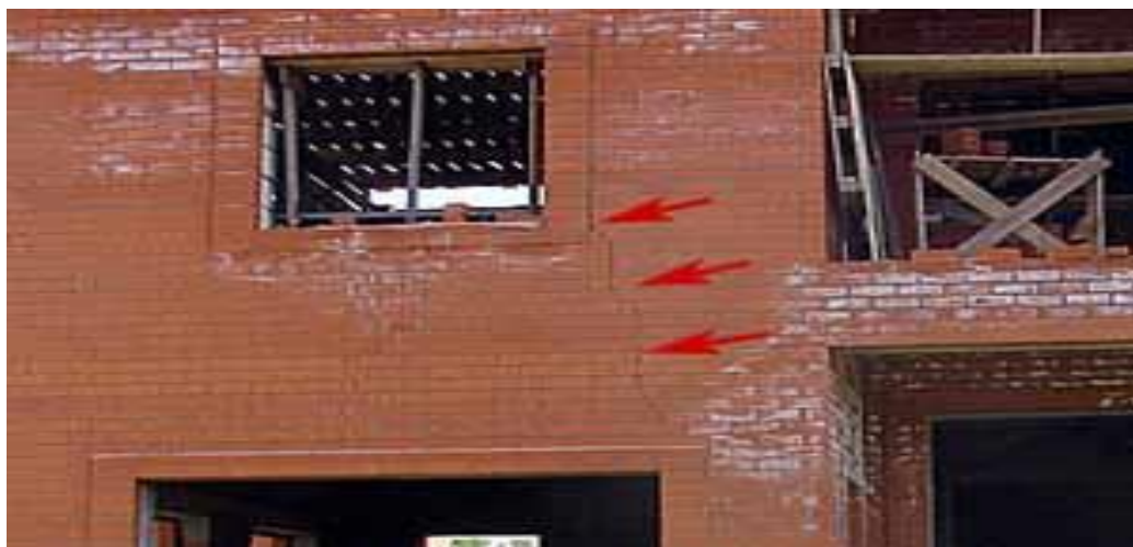
Рис. 1.8 – Легке пошкодження будівлі.
