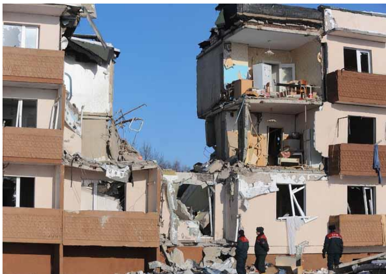
Рис. 1.5 – Сильне руйнування будівлі
