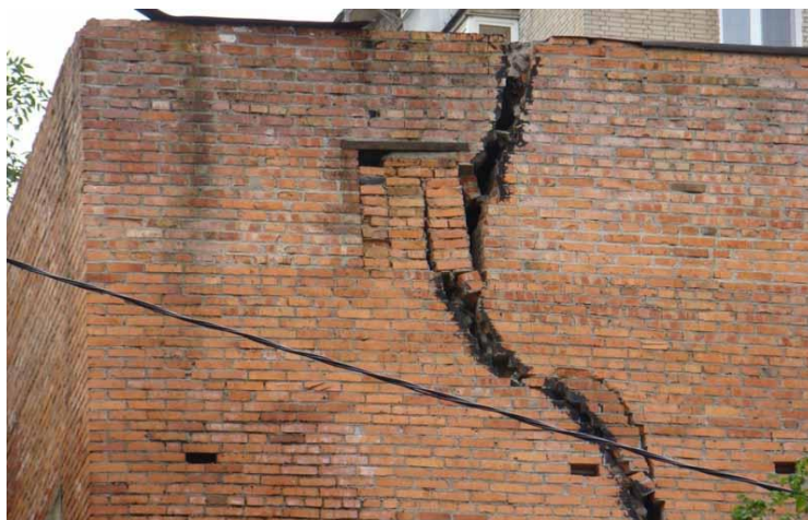
Рис. 1.6– Середнє руйнування будівлі
