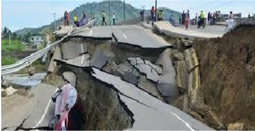
Рис. 2.4 Руйнування дороги в результаті землетрусів у Тайвані (2018 р.)
