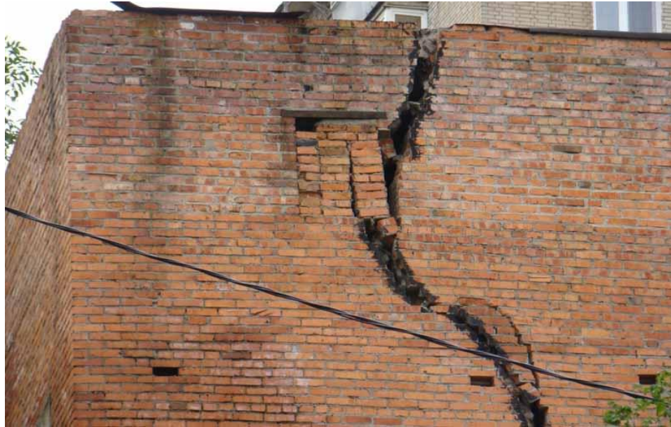
Рисунок 4.7 – Середнє руйнування будівлі
