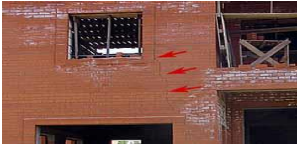
Рисунок 4.5 – Легке пошкодження будівлі.
