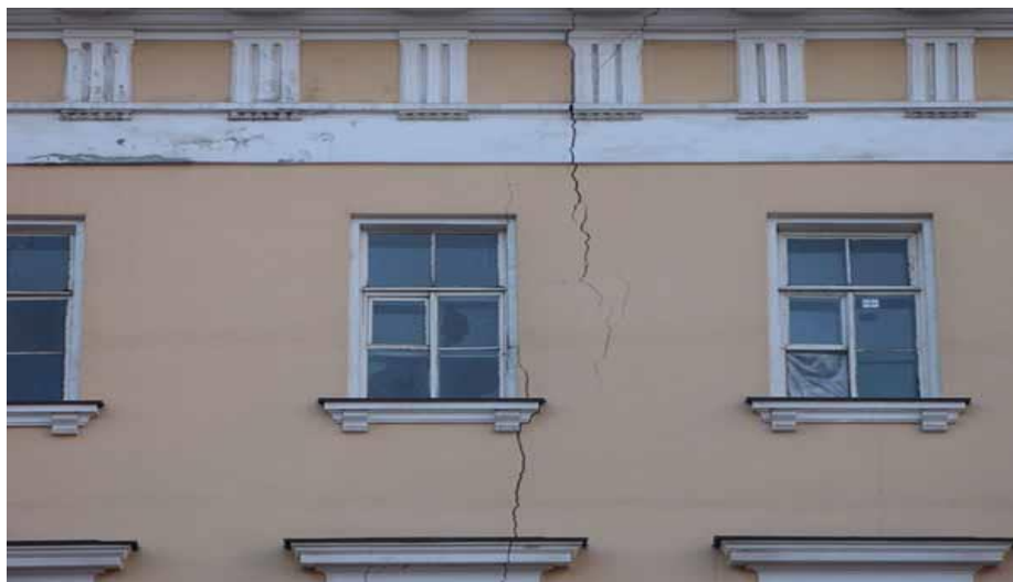
Рисунок 4.6 – Слабке руйнування будівлі
