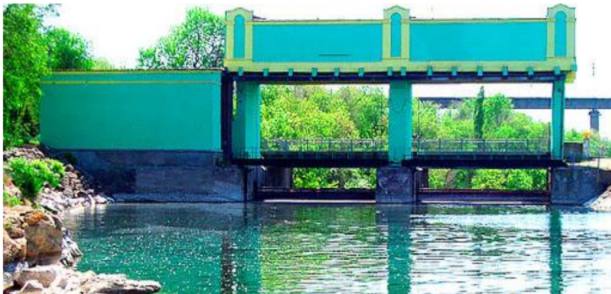
Рисунок 7.9 – Преаерація водозабірною ковша Карачунівського водопровідного комплексу (м. Кривий Ріг)
