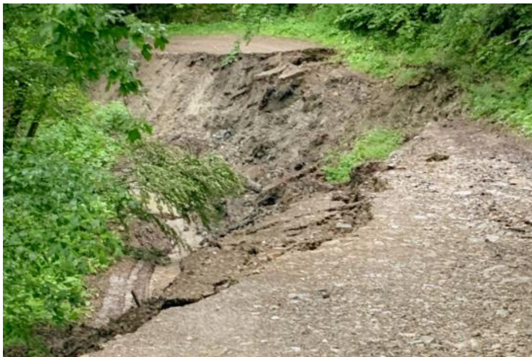
Рисунок 7.4 – Зсув ґрунту на автодорозі Східниця – Орів.
