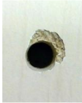
Рис. 2. Дефект обработки сверлением
